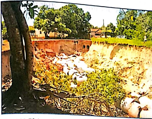
Fig. 148 Efeitos da erosão
